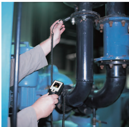
Detección de fugas con sensor separador
